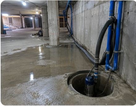
שאיבת מי תהום בחניון התת קרקעי
